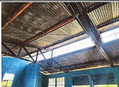
Foto 1: Mantenimiento estructura de techo, en mal estado
